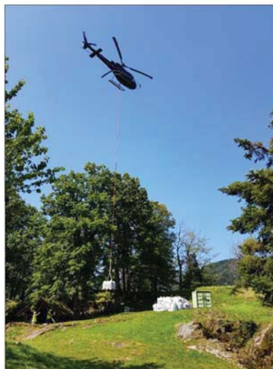
En une matinée, l'hélicoptère a effectué 41 rotations entre le parking du lac et l'enceinte du Schlossberg. Photos DNA/F.S.
