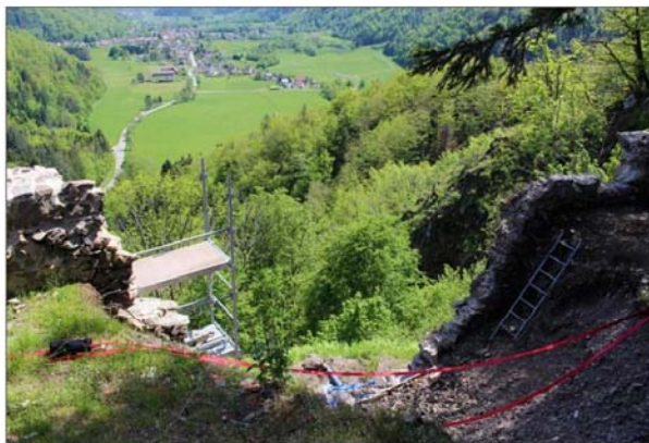
Les lignes de vie installées vont permettre aux salariés, formés chaque année aux travaux encordés, de se lancer dans la reconstruction du parapet... les pieds dans le vide. « On est maintenant dans des conditions de sécurité optimale », estime Aurélie Loewert. Photos L'Alsace/M.S.
